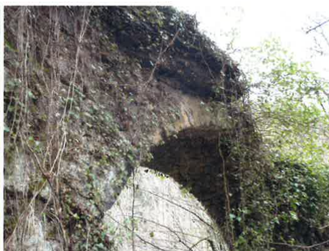
Face amont dégradée – Source © CAUE 64
